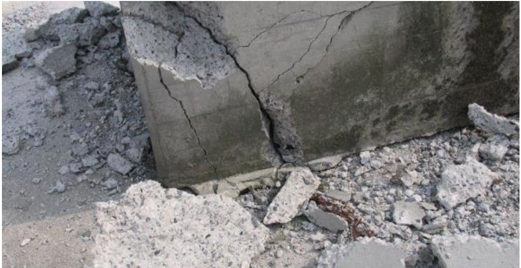
1.4-сурет – Жарықша пайда болған бетон конструкциясы
